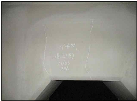
내부 격벽 균열(S2)
