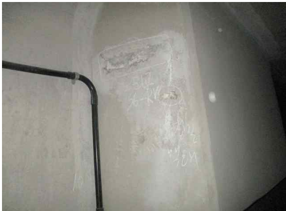
거더 내부 정착구 백태(S6)
