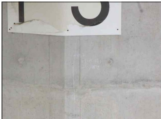
교각 기둥 균열(P3)
