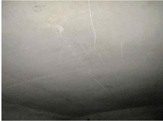
거더내부 상면 균열(S1)
