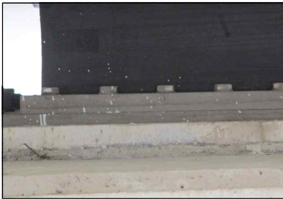
받침몰탈 균열(P5 SH1)
