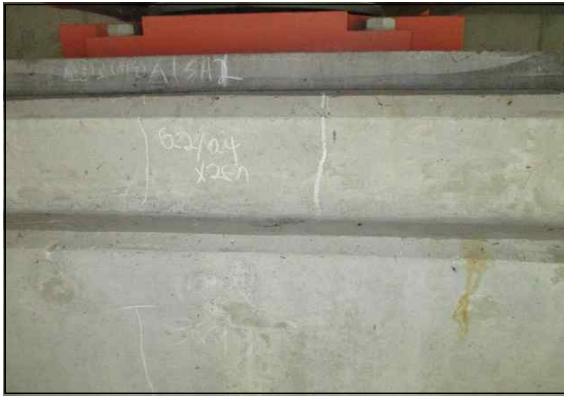
받침콘크리트 균열(A1 SH2)
