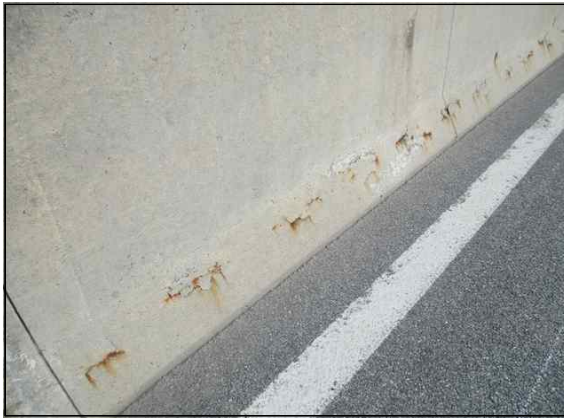
방호벽 들뜸 및 철근노출(S4)
