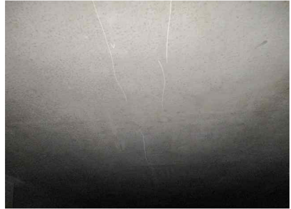
거더내부 상면 균열(S5)
