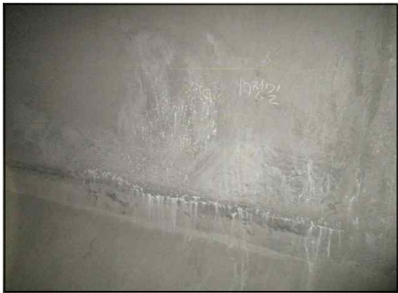
거더 내부 우측면 백태(S6)
