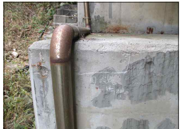
교대 콘크리트 박리(A2)
