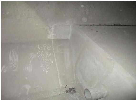
거더 내부 좌측면 들뜸(S6)
