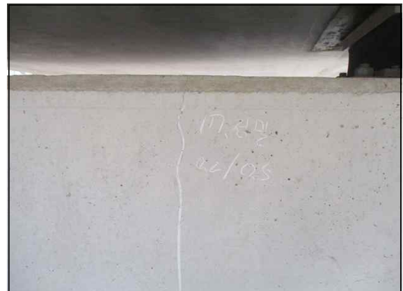
교각 기둥 균열(P6)
